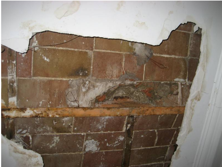
Foto 1.- Detalle abertura, manchas humedad y oxidación.
