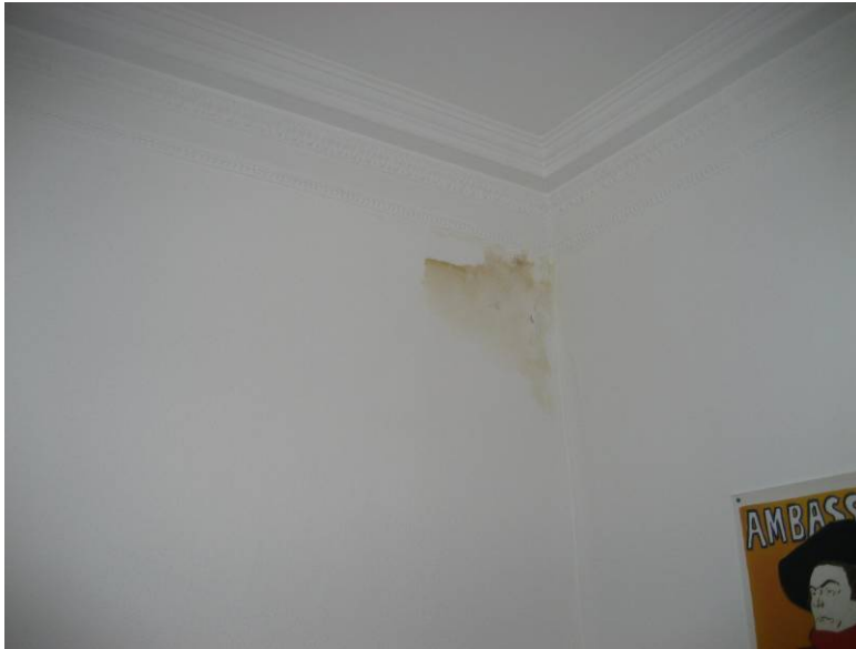
Foto 3. Mancha puntual de humedad.
