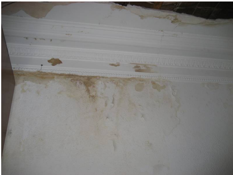
Foto 2.- Afectación en pared medianera.
