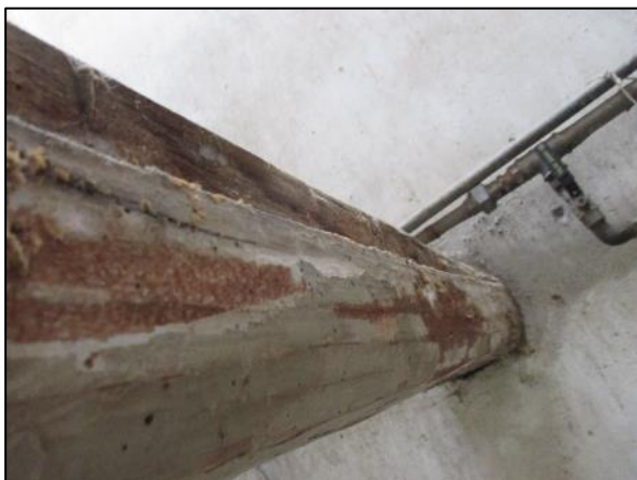
Foto 10.- Detalle estado viga techo P1 en patio
