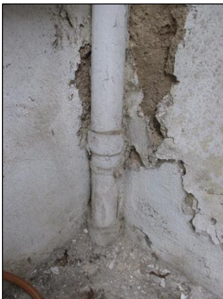
Foto 35.- Detalle degradación mortero revestimiento
