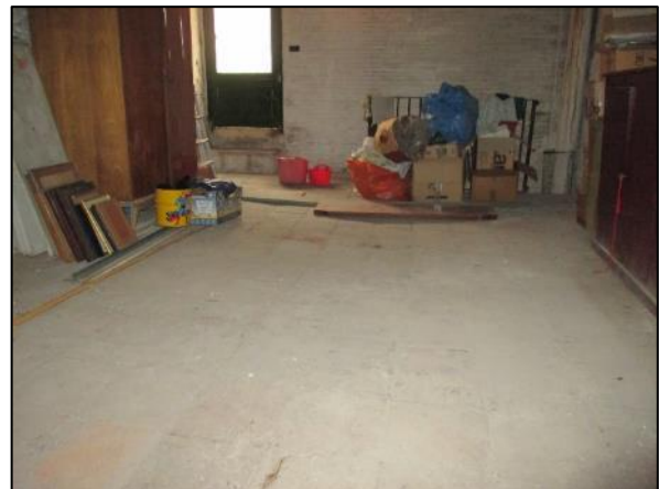
Foto 30.- Hundimiento suelo planta superior
