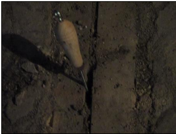
Fotos 23.- Grieta en viga de madera donde se ha retirado el material que la colmataba.
