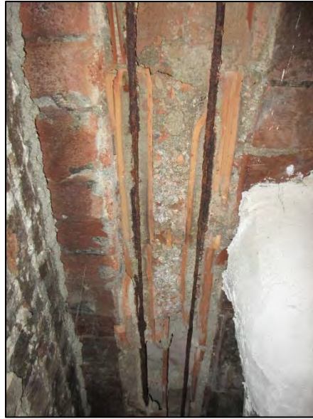
Foto 4.- Pérdida de sección armadura y recubrimiento.
