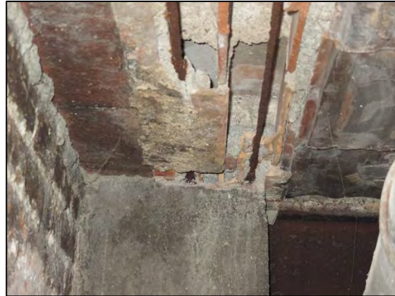
Foto 2.- Detalle viga cerámica armada.
