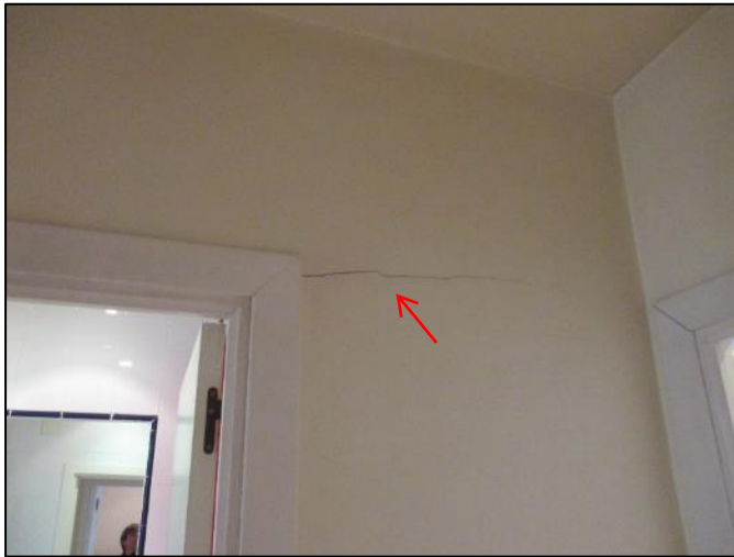
Foto 1.- Fisura en yeso pared pasillo.
