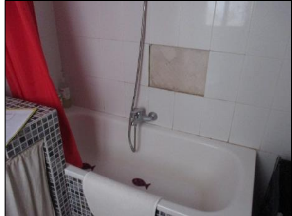
Foto 7.- Bañera en baño junto a pared fisurada.
