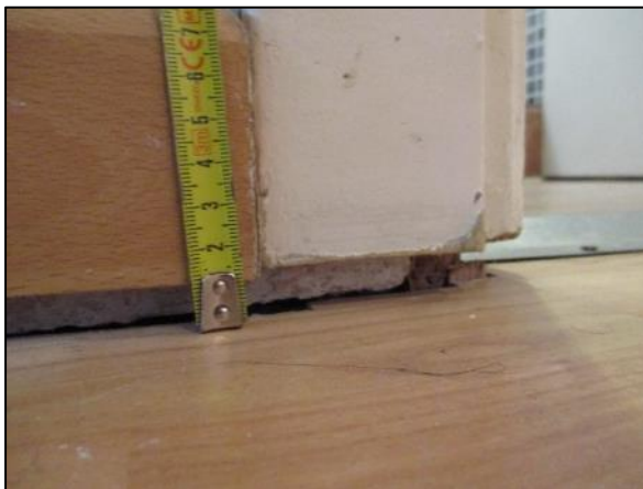
Foto 11.- Junta entre parquet y marco puerta baño.
