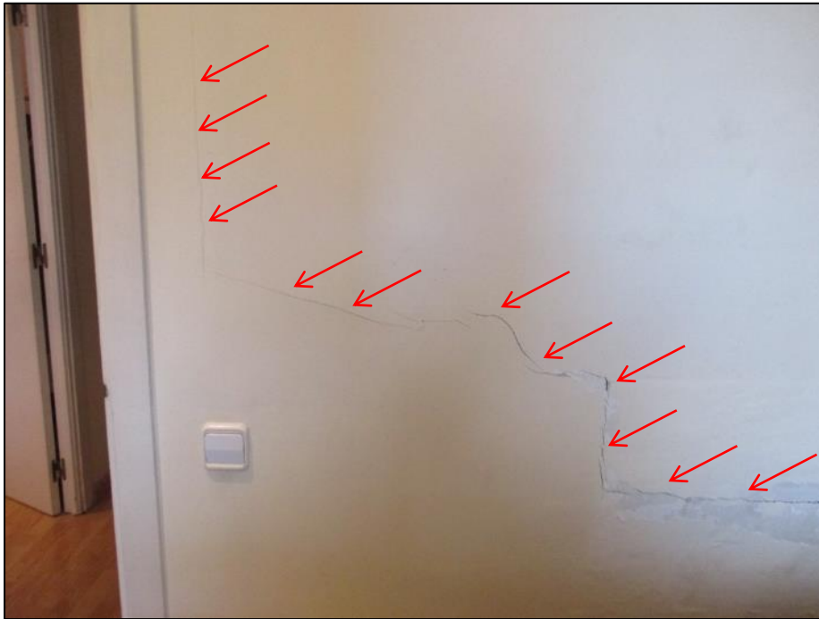
Foto 3.- Fisura en tabique entre habitación posterior y baño.
