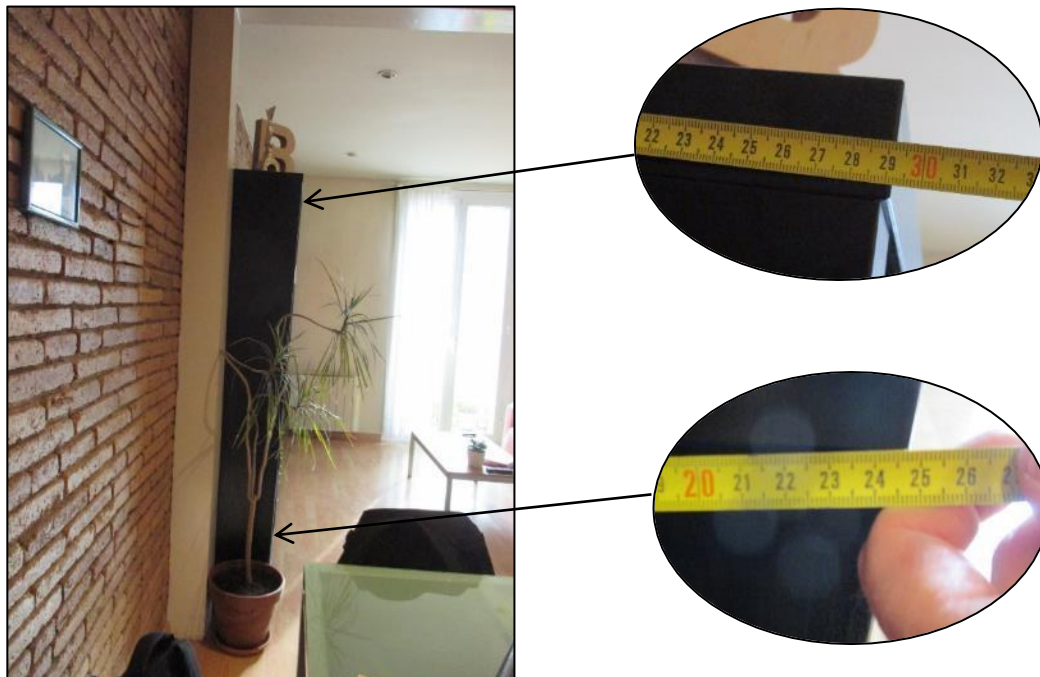
Foto 16.- Desplome en mueble junto a medianera.
